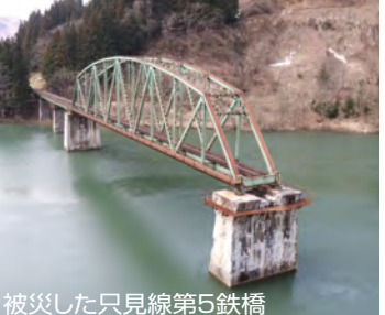
被災した只見線第5鉄橋
